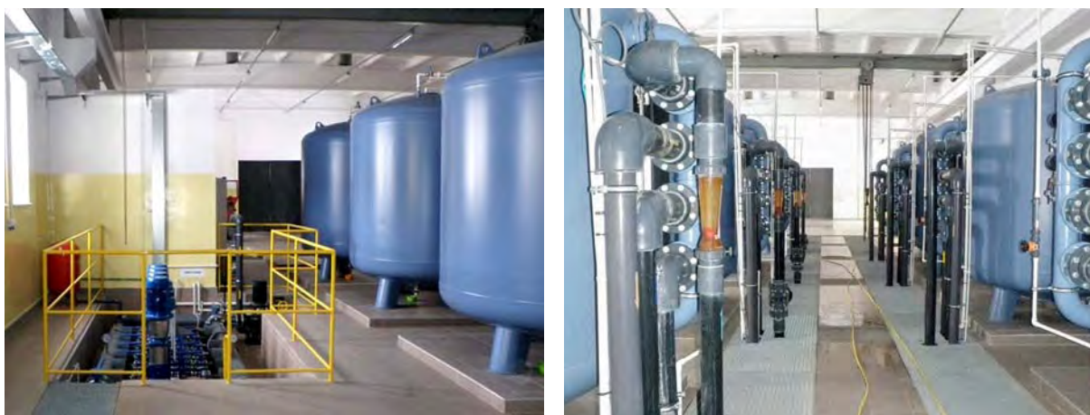
Ryc. 3.1.2. Stacja uzdatniania wody podziemnej w Sieniawie, gm. Sieniawa 2011 r. [44]
