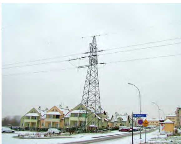
Ryc. 6.1.1. Linia wysokiego napięcia w rejonie osiedla Przybyszówka w Rzeszowie, 2006 r. [44]
